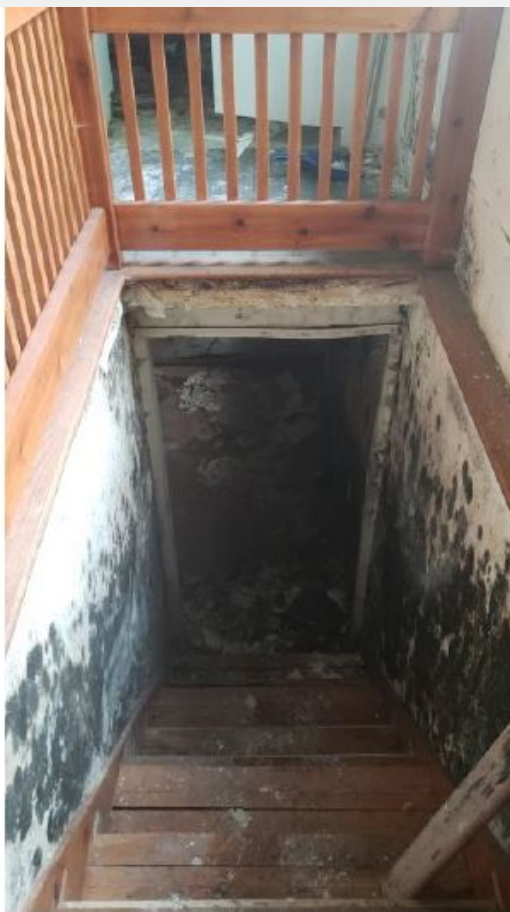
ii. moisissure dans l'escalier
