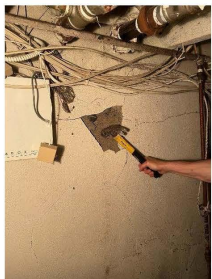
Photo 5 : L'ensemble des fondations du bâtiment d'origine est en très mauvais état. De simples coups de marteau endommagent grandement la fondation. Un taux d'humidité important au sous-sol est l'une des causes de la dégradation de la condition des murs.
