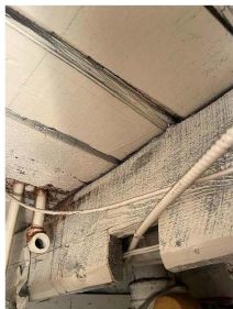
Photo 4 : Certaines solives ont été percées pour le passage de mécanique. Le plancher consiste en des planches de +/- 1" x 6" appuyées sur les solives. En majorité, les planches ne sont pas en bon état.
