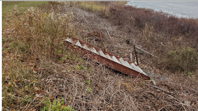
Photo 5. Recouvrement de vignes sur le talus qui est plus ou moins faiblement en érosion (0+325).
