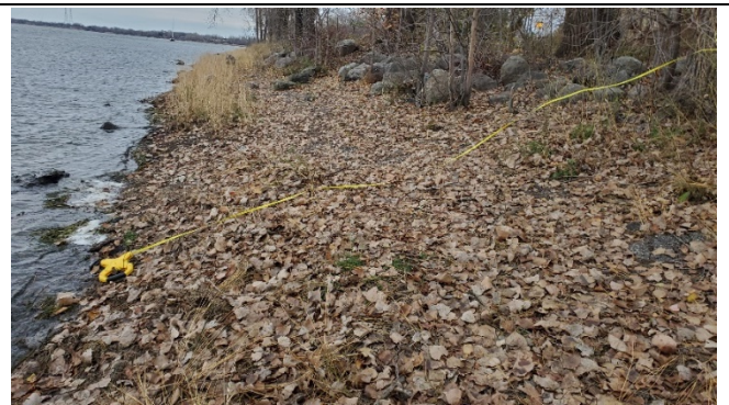
Photo 2. Enrochement observé vers 0+703
