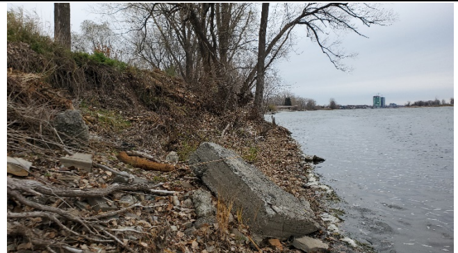
Photo 8. Présence de déchet et d'érosion le long du talus en berge (tronçon nord).
