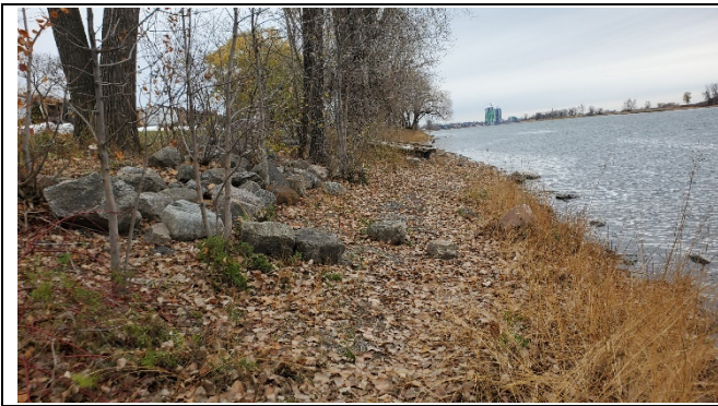
Photo 3. Enrochement observé vers 0+550
