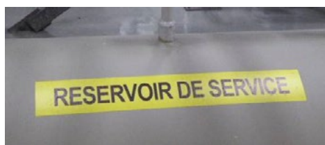
Figure 10.4.5 – Réservoir de service
